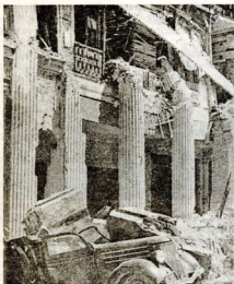
Imágenes de un edificio peruano, en que sus columnas fueron dobladas por la fuerza del terremoto. (9)
